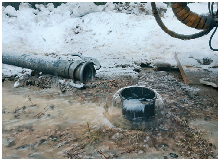
Kuva 7. Pohjavettä purkautuu omalla paineellaan Syrjäharjun porakaivosta DW2 23.1.2020. Suojaputken sisähalkaisija 168 mm, vedentulo noin 150 m 3 /vrk. Kuva: Ossi Alho
